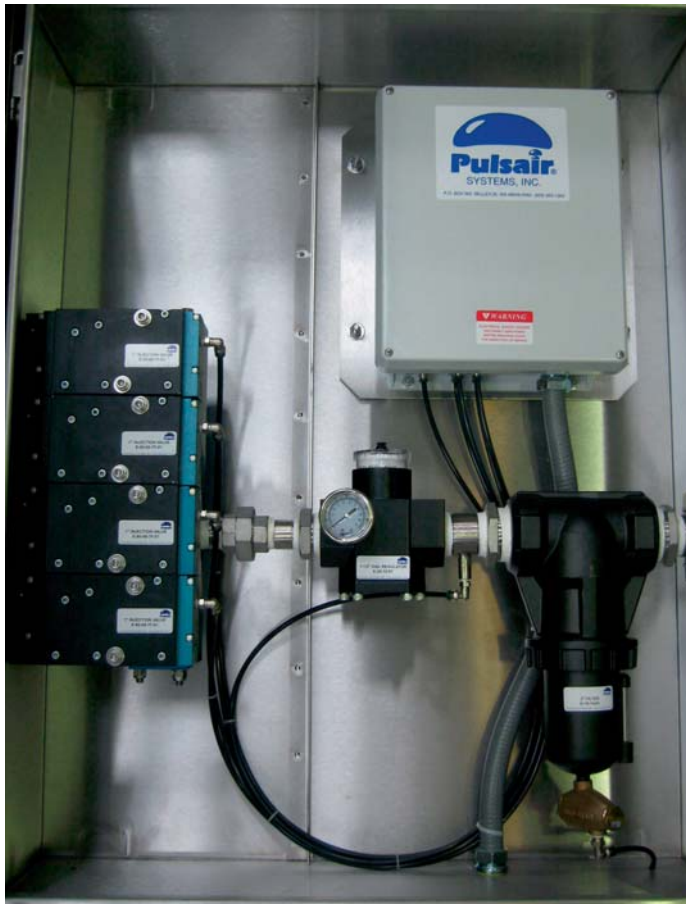
Abb. 2: Gehäuse mit elektropneumatischem Umwandler (oben) sowie (v.l.) vier Impfventilen, einem Druckregler mit Manometer und einem Filter
